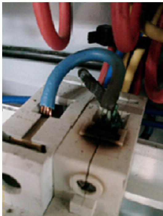
Figura 2: Identificação da falha.
